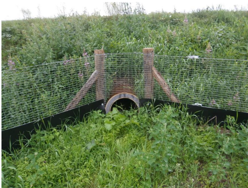
Figuur 10: Voorbeeld fauna doorgang in het hekwerk
