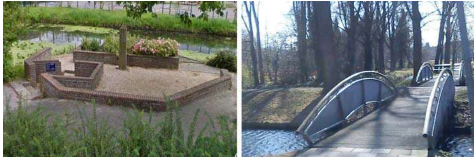
Figuur 5-1 In het kunstwerk op de Sniplaan (links) zijn 2 hoogtebouten aangebracht. In de landhoofden van de twee bruggen bij het 'Hof van Delft' (rechts) zijn 4 hoogtebouten aangebracht.
