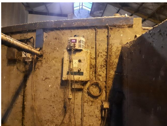
Regeltransformator voor koeherkenningssysteem
