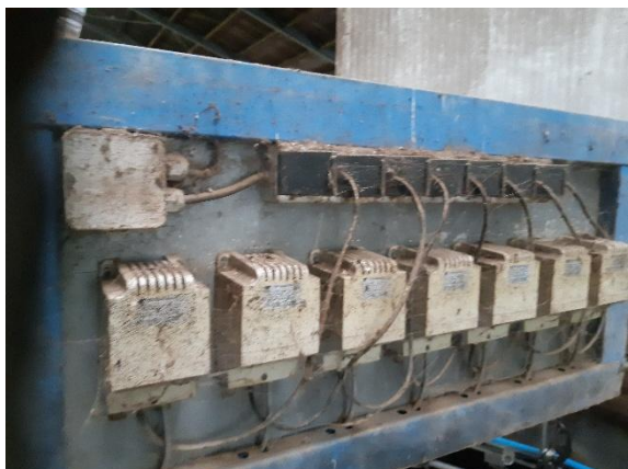
6 Voedingen met transformatoren
