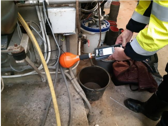
Veldsterkte meting bij binnenkomst voedingskabel in technische ruimte (16)
