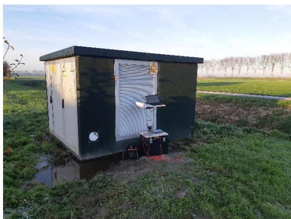
Foto transformator bedrijf A
