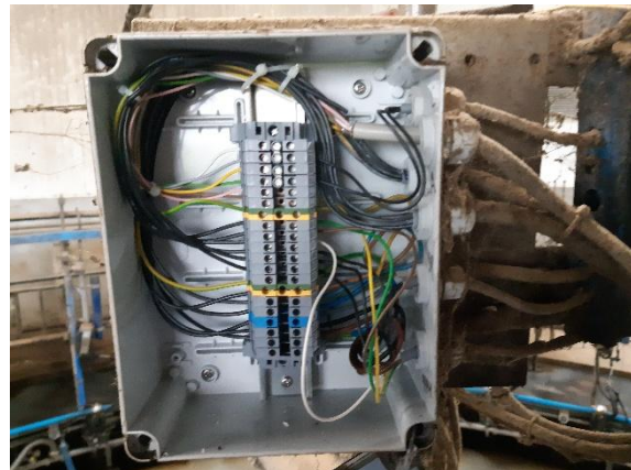
2 Aansluitdoos met bekabeling vanuit besturingskast
