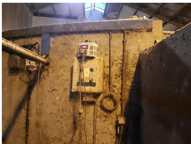
Foto 2: Het koe-herkenningssysteem met daarop een regeltransformator.
