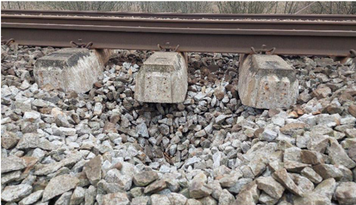
Afbeelding 3.3: verzakking spoorrail als gevolg van bevergraverij, Bron: Beverdilemma bij het spoor | ProRail , februari 2022
