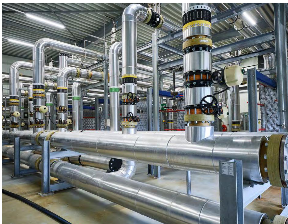
Foto: Geothermie installatie gemeente Westland.
